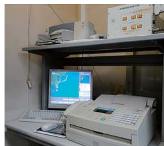
福岡県防災・行政情報通信ネットワーク。衛星回線を利用して防災情報が送られてくる他、福岡県と大牟田市とのホットラインの役割を果たす
