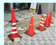
村庁舎玄関の被害
