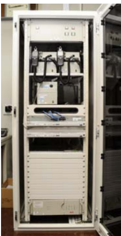
●泉南市防災用広報システムサーバー。市役所に親局の本局、消防署には補助局を設置。
