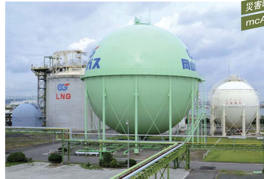
岡山ガス築港工場にはプラント設備や管理棟、コントロールセンターなどがあります。
