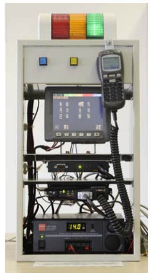
●築港工場の「災害時緊急通報システム」。水島基地から倉敷営業所への天然ガス供給がストップすると、赤ランプの点滅とブザーで緊急通報します。
