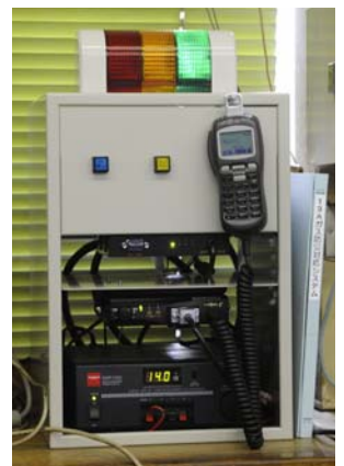
●大口顧客に設置された「災害時緊急通報システム」。
