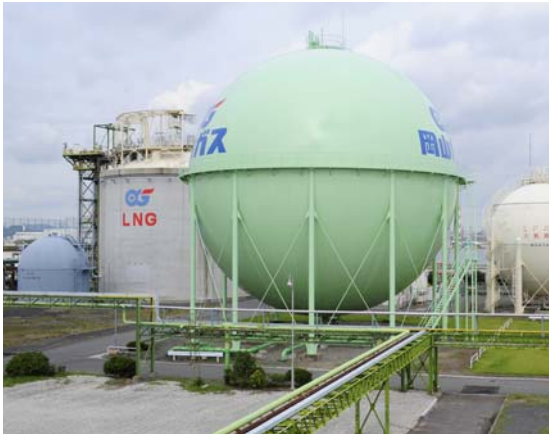
●岡山ガス築港工場。LNGの受入から、都市ガスの製造、送出までを行います。敷地内にはプラント設備や管理棟、コントロールセンターなどがあります。
